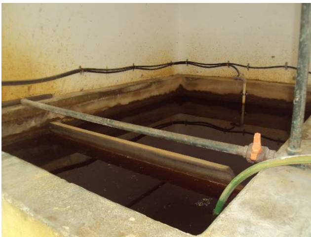
Figura 18 – Tanque de preparo de produto químico
