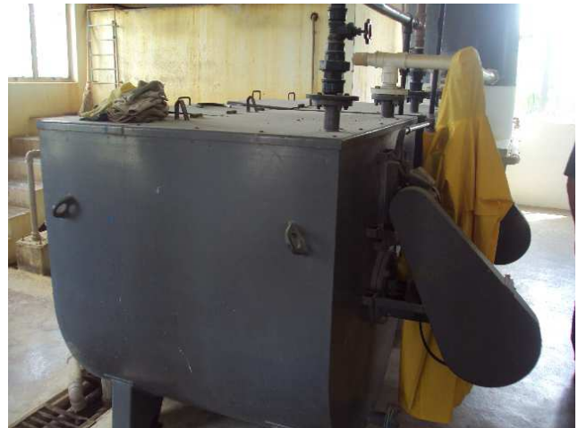
Figura 17 - Dosadores de produtos químicos
