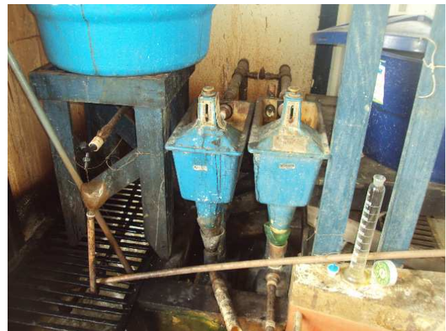
Figura 19 – Dosadores de produtos químicos
