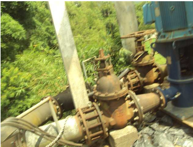
Figura 10 – Captação água bruta (equipamentos)
