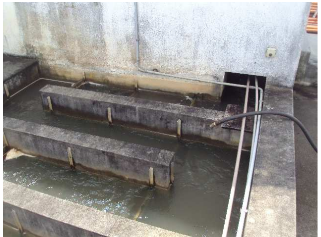
Figura 23 – Detalhes dos Floculadores hidráulicos
