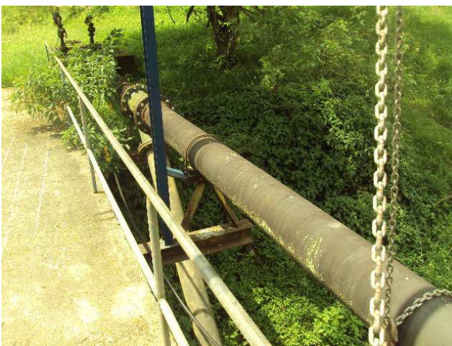
Figura 12 – Adutora de água bruta
