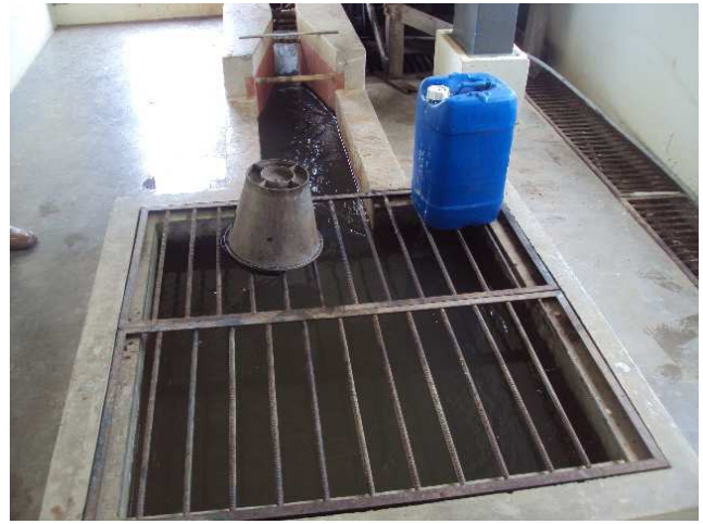
Figura 21 – ETA - Canal de entrada da água
