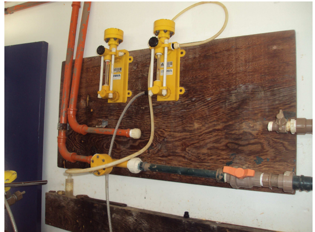
Figura 27 – Dosadores de cloro gás
