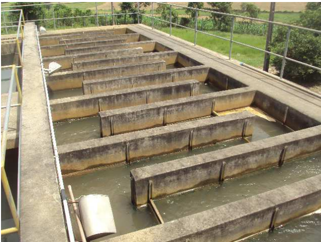
Figura 22 – ETA – Floculadores hidráulicos
