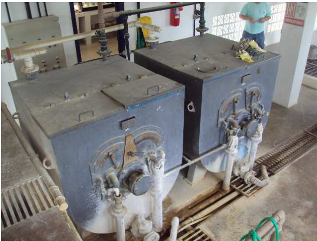
Figura 16 - Dosadores de produtos químicos
