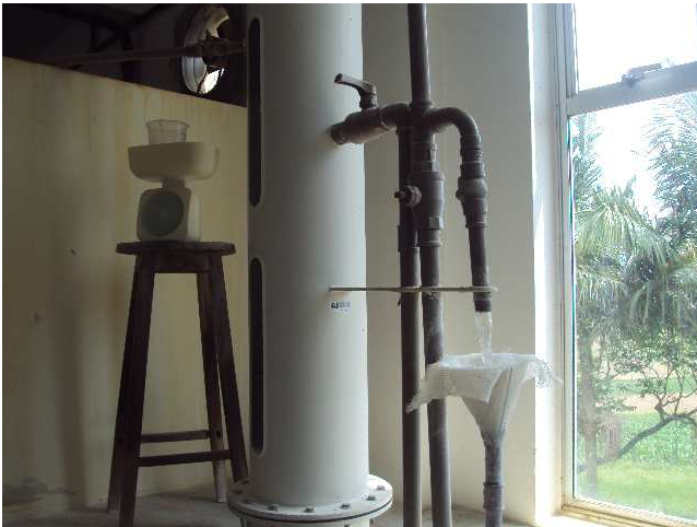
Figura 20 - Dosadores de produtos químicos
