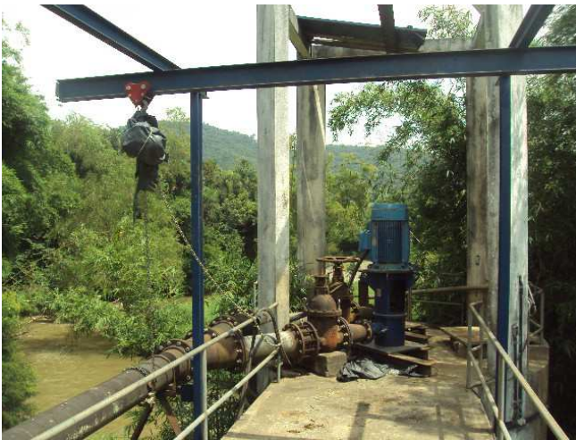
Figura 8 – Captação de água bruta
