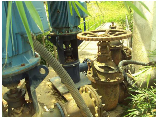
Figura 11 – Registro e bombas da captação
